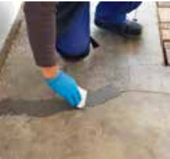
Sigilați fisurile din beton
